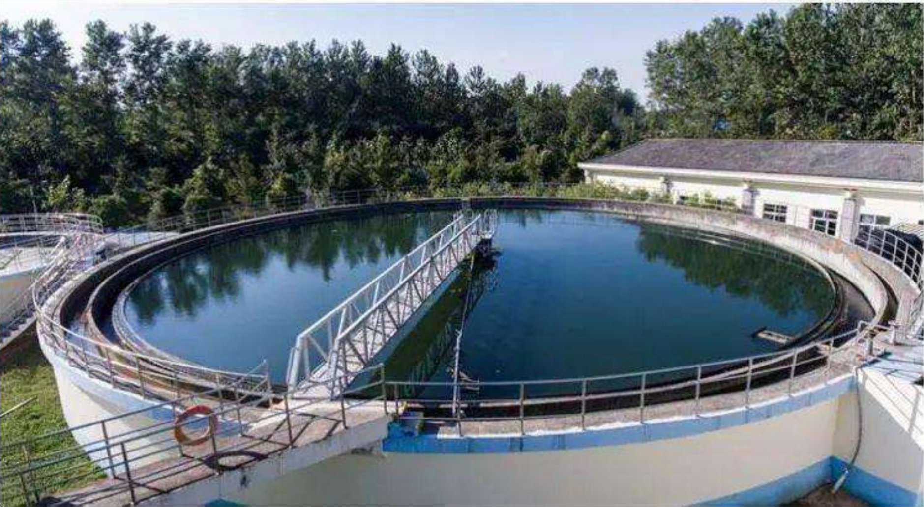
辐流式沉淀池
